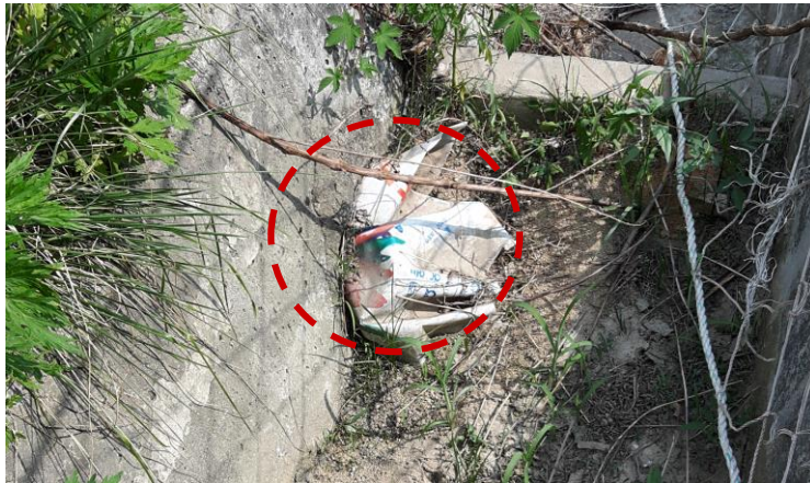
배수로 퇴적물로 유입부 막힘
