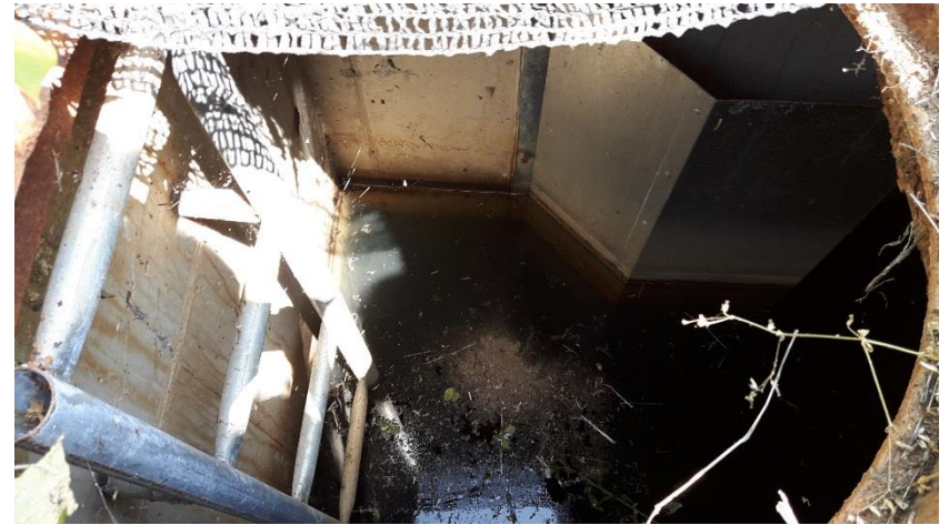
여재폐색되어 초기우수가 미처리 방류
