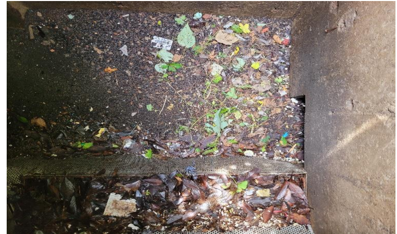
유입부에 퇴적물 및 협잡물 과다
