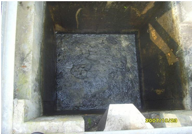
전처리조내 다량의 침전물질 발생
