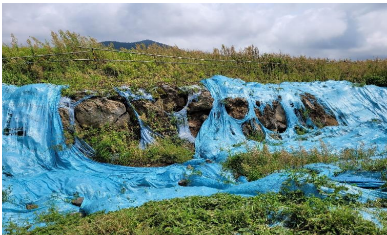
침사지 사면 붕괴 및 방수포 관리 불량
